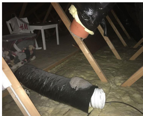
| ventileringsrør med manglende vedhæftning til taghætte.
