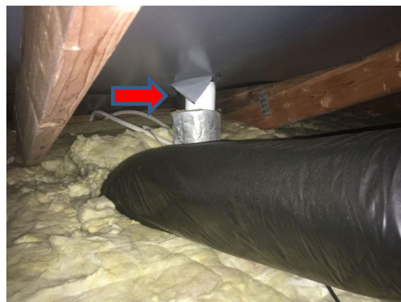
| Undertag med manglende tæthed.
