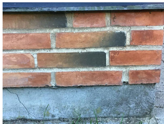
| Skade på sokkelpuds og facade
