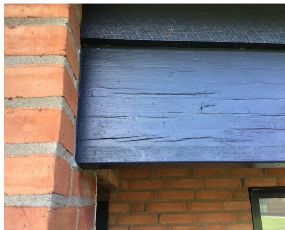
| Synlig rem fremstår slidte og der ses delaminering.
