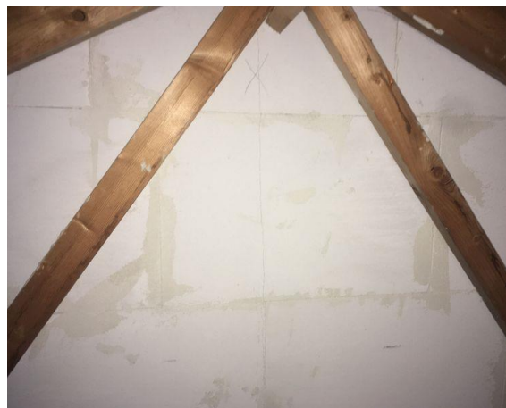
| revnedannelse i gavlvæg
